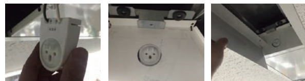
④新設ソケット 側面から配線が出ている。
