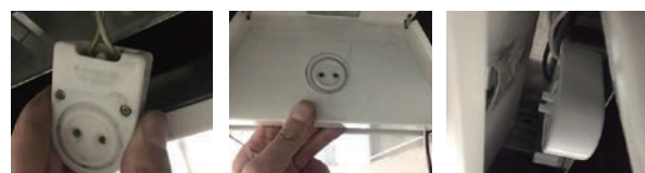
①既設ソケット 上側から配線が出ている。
