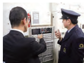
警備インスペクション (消防設備操作状況)
