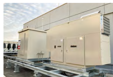
非常用発電機
