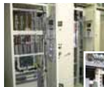
遮断機 操作訓練
