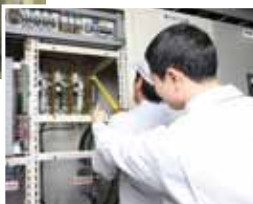
高圧受変電設備
